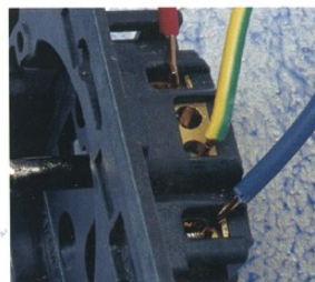
5. Raccordement dangereux. L'isolant est enlevé sur une trop grande hauteur, d'où risque d'électrisation.
