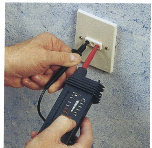
Vérification de l'absence de tension aux bornes de la prise (diodes éteintes).
